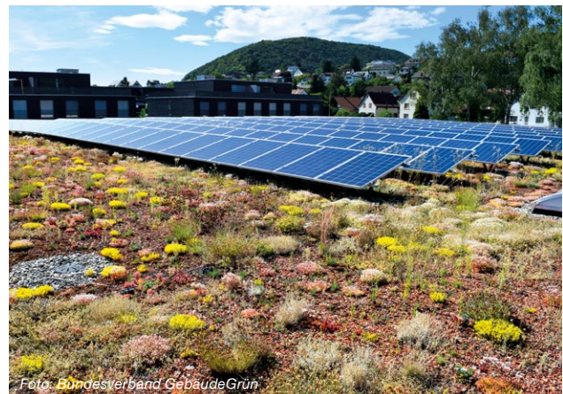
Abbildung 4: Extensive Dachbegrünung in Kombination mit PV-Anlage.
