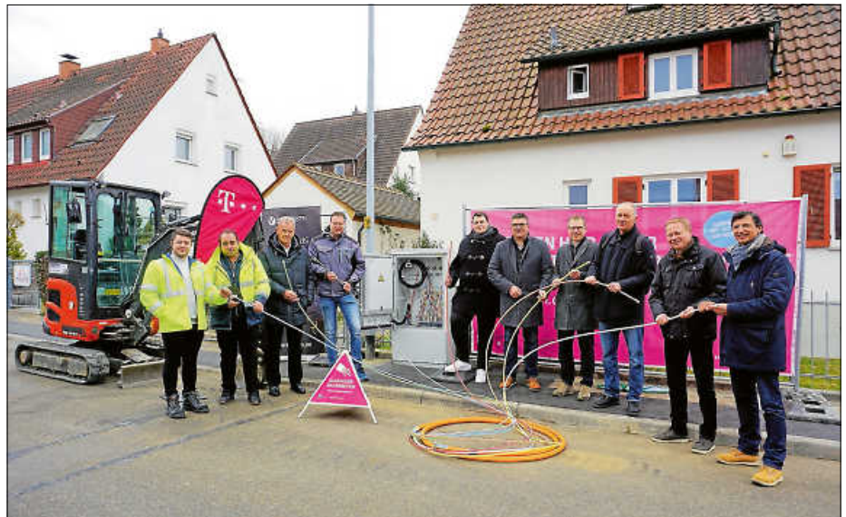
v.l.: Stefan Pidghirni (Constructel), Claus Costa (Bauleiter Constructel), Frank Faas (Telekom), Ulrich Biedermann (Abteilungsleiter Tiefbau), Richy Bauer (Wirtschaftsförderer), Jürgen Wolf (Telekom), Bürgermeister Steffen Weigel, Helmuth Haag (Gigabit Region Stuttgart), Markus Grupp (Kreiswirtschaftsförderer/Geschäftsführer Zweckverband Breitbandversorgung Landkreis Esslingen), Luis Antunes (Constructel)
